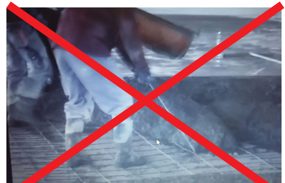
TIRANDO CON GANCHO, MALLA MAL COLOCADA
