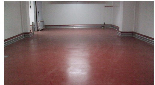
CÁMARA FRIO CANARIAS
