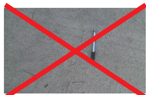
FIBRA ACERO, ESCASA, OXIDADA, SE DESPRENDEN CON LA ABRASIÓN
