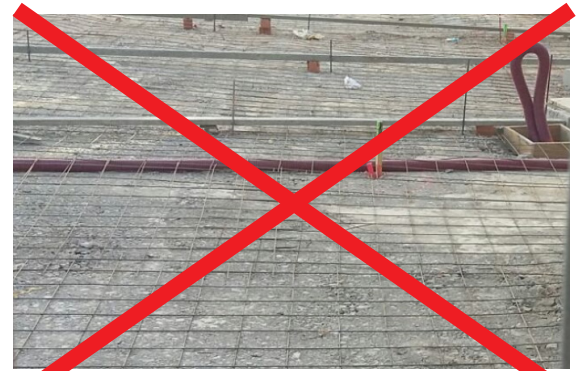
MALLA INUTIL APOYADA EN EL SUELO
