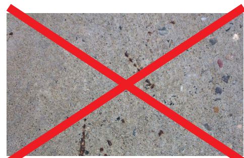
ACERO ESCASO, OXIDADO EN SUPERFICIE Y SE DESPRENDE
