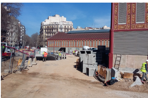
CÁMARAS FRÍO MERCAT DE SANT ANTONI BARCELONA
